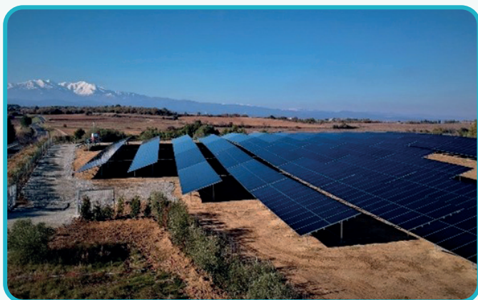
Parc photovoltaïque du « Mas d'en Ramis » à Banyuls-dels-Aspres
